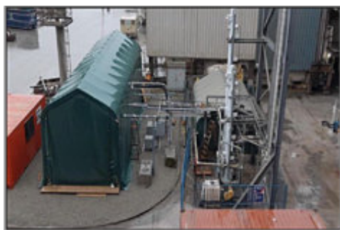
Figura 3: Planta de Captura de CO 2 de Svante (Fase 1 + Fase 2) en la Planta de Cemento Lafarge en Richmond, Virginia (Gerdes, 2022).
